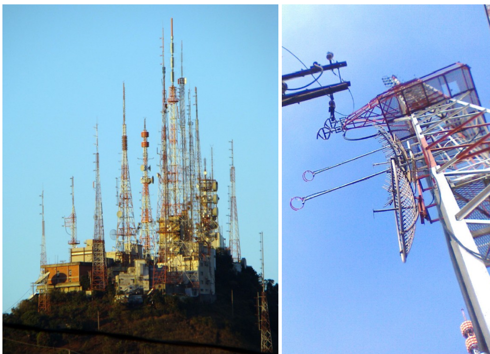
Figura 6 – Centro de transmissão da Itatiaia: Na esquerda, visão global da estação antenas da instalação da antena. Na direita, antena DRM+ instalada no mastro (duas antenas inferiores).
